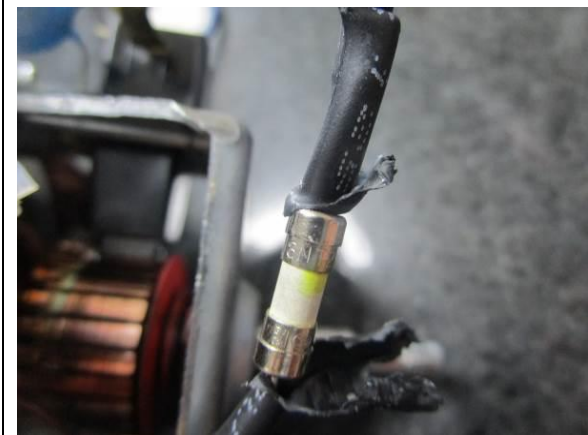
71). Fuse in motor
